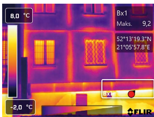
Rys. 5 Zdjęcie termowizyjne cokołu na elewacji wschodniej
