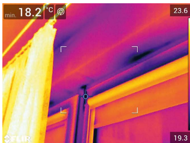
Rys. 3. Mostki termiczne nad otworem okiennym (zdjęcie własne)
