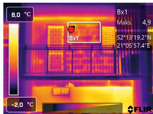
Rys. 8. Zdjęcie termowizyjne strefy balkonowej elewacji południowej
