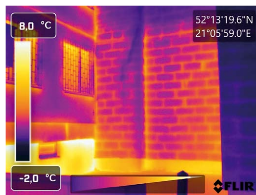
Rys. 7. Zdjęcie termowizyjne połączenia budynku z wielkimi płytami z budynkiem w technologii tradycyjnej
