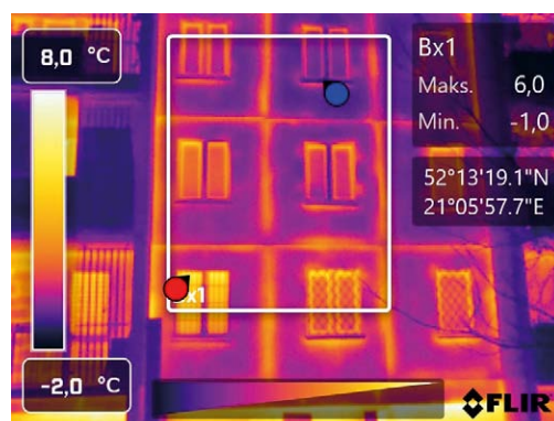
Rys. 3. Zdjęcie termowizyjne elewacji południowej
