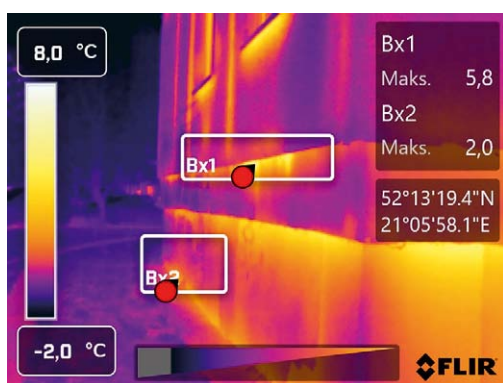
Rys. 6. Zdjęcie termowizyjne cokołu na elewacji wschodniej
