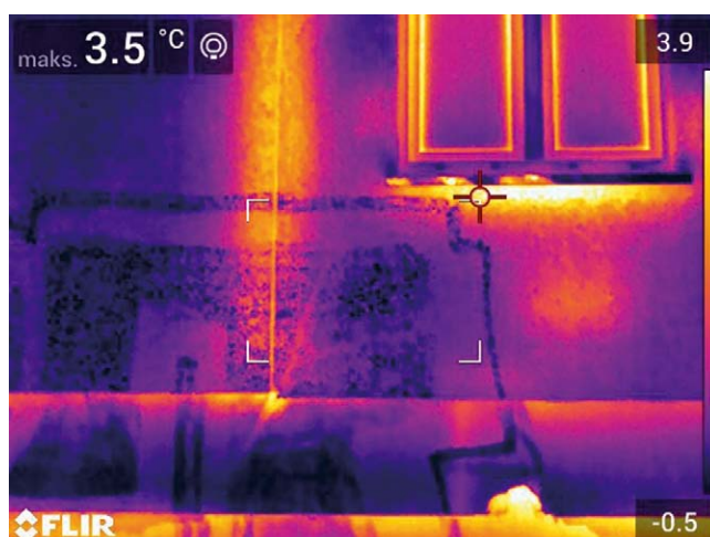
Rys. 4. Mostki termiczne na ścianie zewnętrznej budynku (zdjęcie własne)
